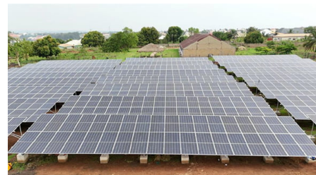
フジ オイル ガーナでは太陽光パネルを導入
