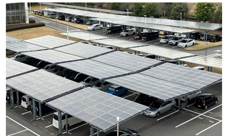
不二製油(株)関東工場では初のカーポート設置型太陽光パネルを導入
