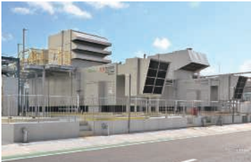
不二製油(株)阪南事業所のコージェネレーション設備
