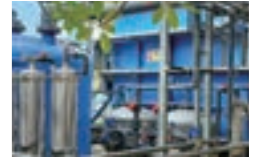
新たに導入した浄水システム
