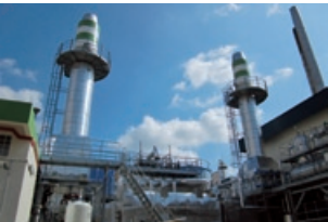
フジオイル(シンガポール)社 コ・ジェネレーションシステム
