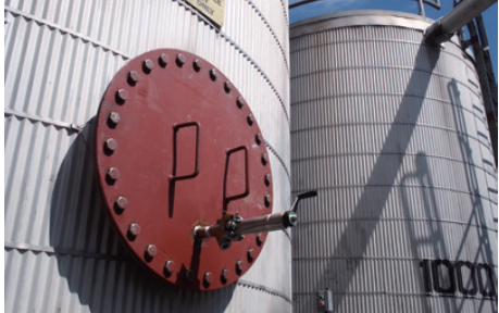
槽罐上安装的阀门
