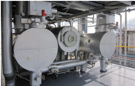
阪南事业所新除臭塔节能型真空装置
