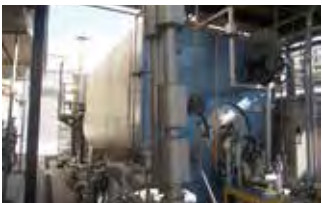
副产品油锅炉
