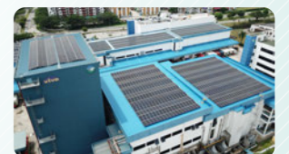
安装在屋顶上的太阳能板
