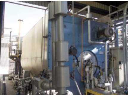
バイプロ油ボイラー
