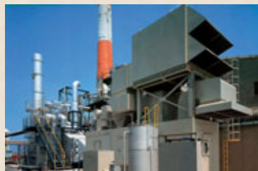
コ・ジェネレーションシステム1号機
