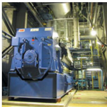
コ・ジェネレーションシステムの導入
